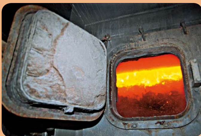
Incineration des déchets dans le four-chaudière.
