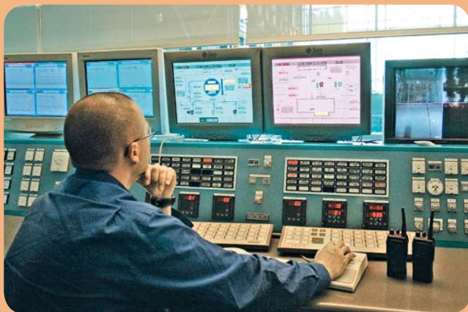
Salle de contrôle-commande.
