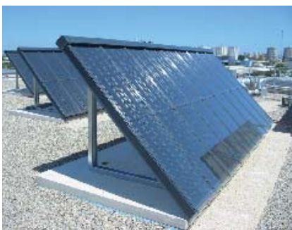
Les capteurs solaires couvrent 50% des besoins en eau chaude sanitaire au Centre de tri à Nanterre.
