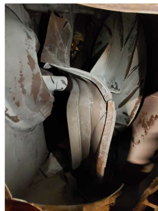
2: Roue et aubages déformés et cassés
