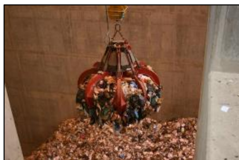
Figure 6 : Grappin sur pont-roulant en fosse
