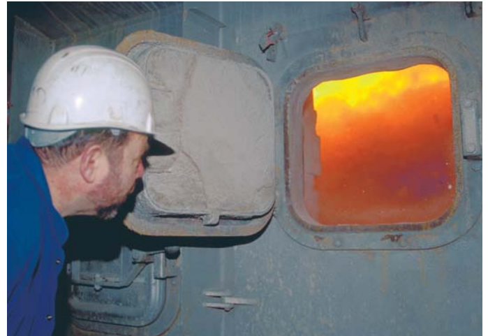
Le four brûle les ordures ménagères à plus de 900 °C. La chaleur ainsi dégagée permet de générer de la vapeur.
