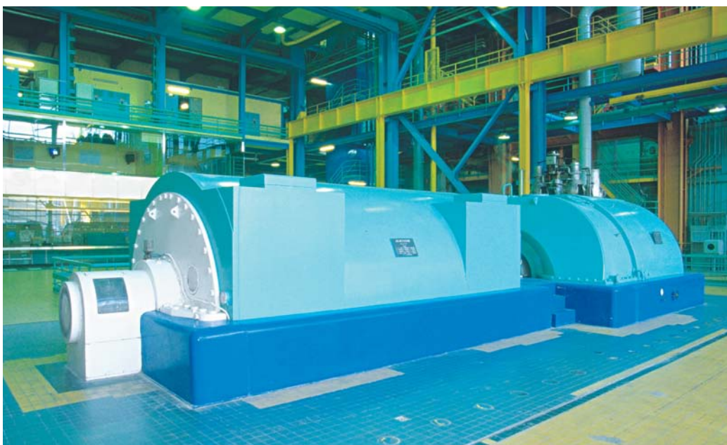
La vapeur permet aussi de produire de l'électricité grâce à un groupe turbo-alternateur.
