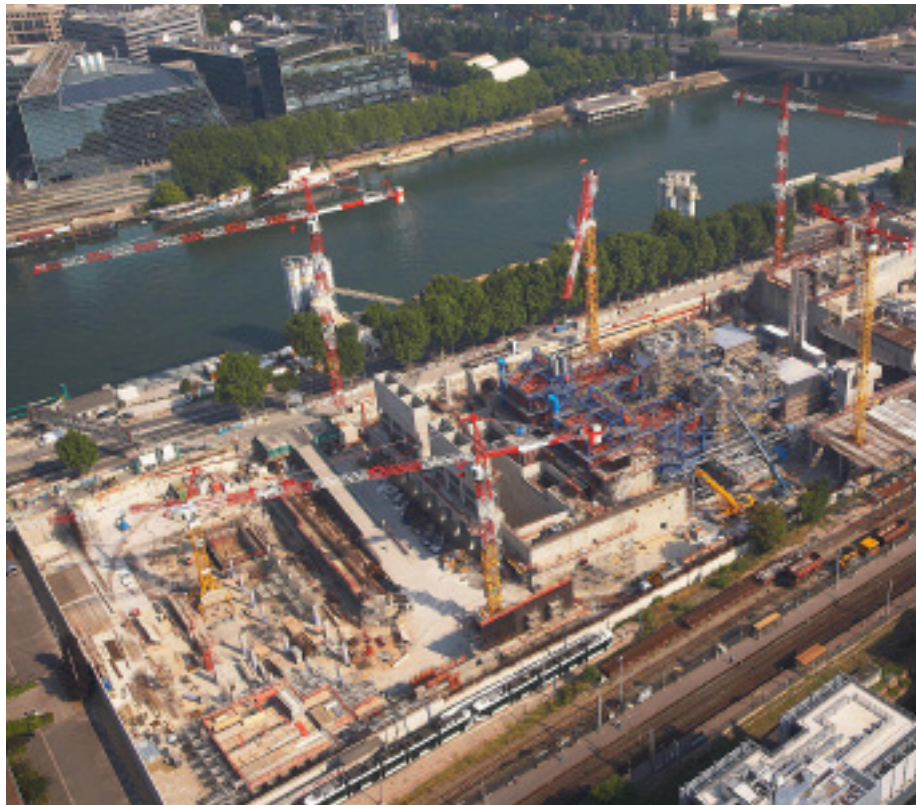
Isséane, un projet environnemental qui a séduit la BEI. Ci-dessus, le chantier à Issy-les-Moulineaux en juin 2006.
