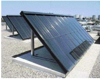
Les capteurs solaires couvrent 50% des besoins en eau chaude sanitaire au centre de tri à Nanterre.
