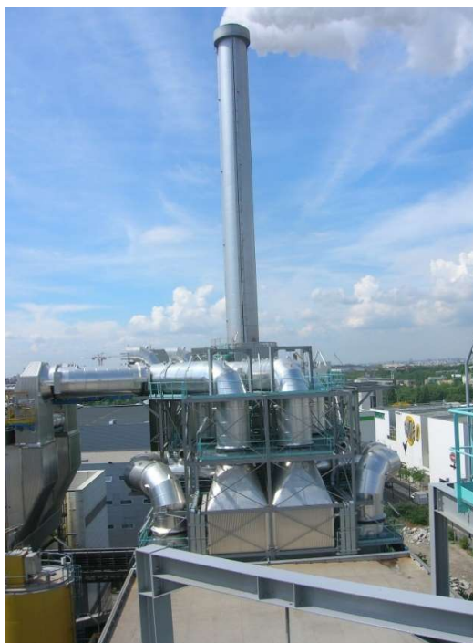
Figure 1 - vue d'une ligne de traitement des fumées
